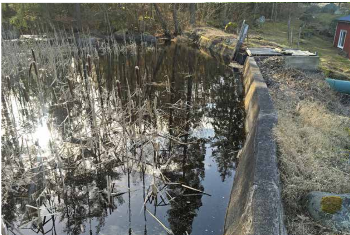
Figur 18. I Mörrumsån med tillflöden finns ett stort antal dämmen av olika typer och storlek. Dämmen vid Ebbamåla bruk med stående planksättar (ovan), jordvall med betongförstärkt dammsida i Kärrsjöbäcken (nedan).
